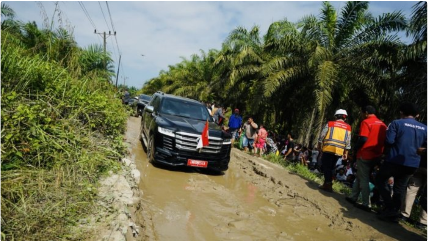
Mobil Presiden Republik Indonesia Ketika Melewati Jalan Rusak di Labura
